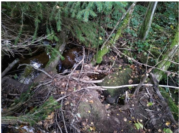
Obstruction totale du lit par un embâcle avec accumulation de sédiments et colmatage du lit - ruisseau de l'Enclose à Tarnac
